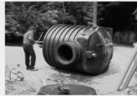
Storage tank, Lambertsühle, Otterwasser GmbH
